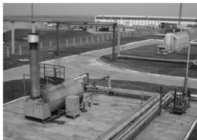
Рис. 1. Общий вид размещения подогревателя топливного пускового газа ПТПГ в составе установки подготовки газа
